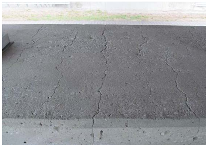
(d) Cracking on top of pier cap
